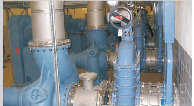
Pumpwerk des RÜB Dresden-Kaditz
