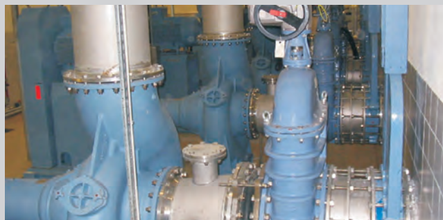
Насосная станция камеры ливнепуска в Дрезден-Кадитц
