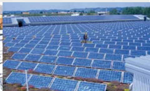
Solaranlage RÜB Dresden
